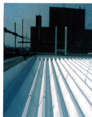
排水機場（断熱・防音対策）
